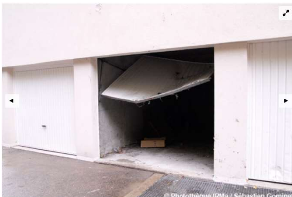
Photo du résultat de chutes de blocs de la falaise de la Bastille en 2009
